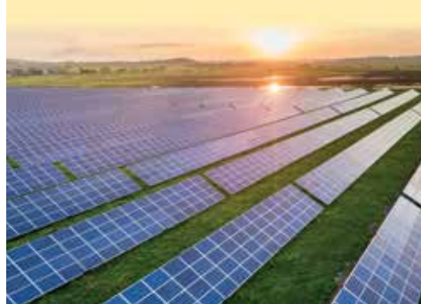
Freiflächenfotovoltaikanlagen leisten einen wertvollen Beitrag zur Energiewende und ermöglichen eine höhere und zugleich emissionsfreie Wertschöpfung aus vorhandener Fläche.
